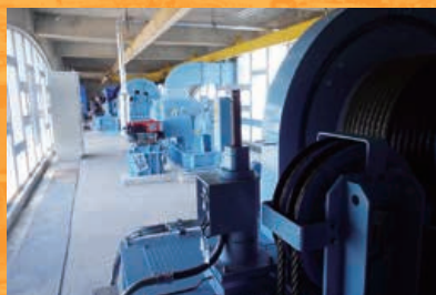
H30_荒川第1排水機場水門巻上げ機詳細ゲート更新設計(福井土木)
