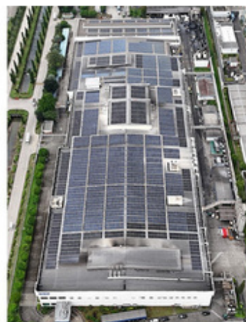
西ジャワ州カラワン県にあるDNPインドネシアの工場の屋根に設置された太陽光発電設備（アラム・エナジー・リニューアブルズ提供）
