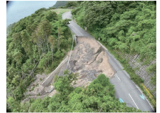
図-10 輪島市被災状況(県道 輪島浦上線)
