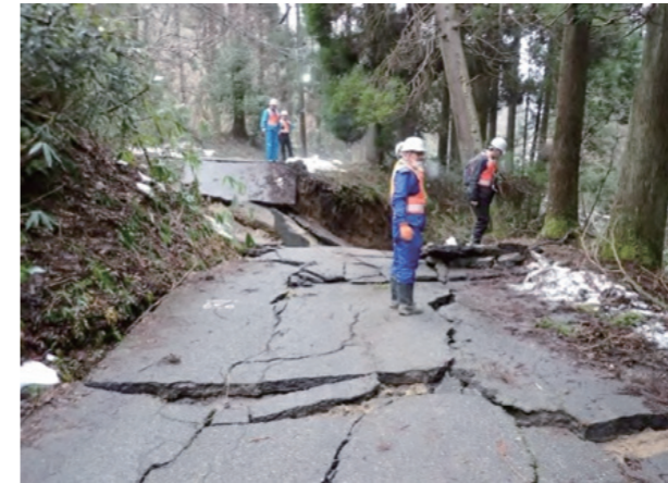
図-8 氷見市被災状況(県道 仏生寺太田線)
