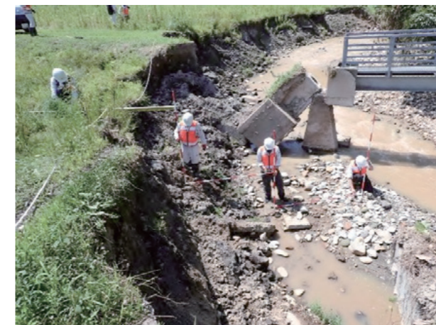
図-2 査定写真撮影状況(一級河川 辺呂川)
