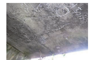
ASRが原因と推定されるひびわれ
