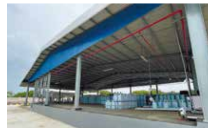
LPガス充填工場
