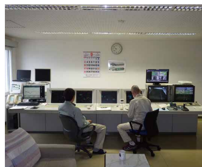
小樽市天神浄水場中央監視制御設備実施設(北海道)
