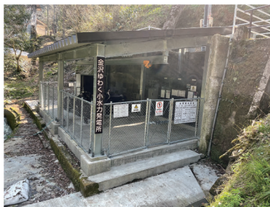
金沢ゆわく小水力発電所
