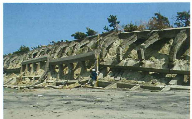
図3：崩壊した防潮堤（仙台湾南部海岸）
