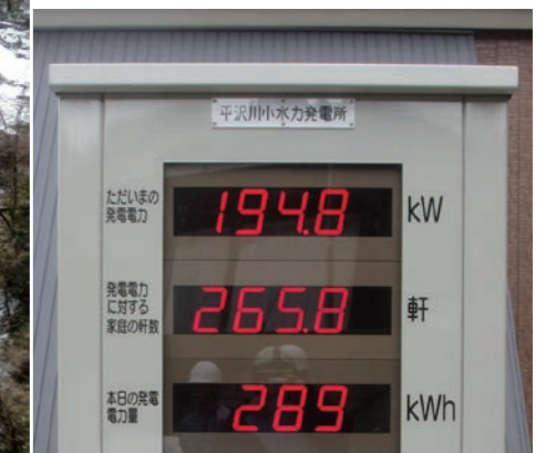
写真9 発電出力パネル
