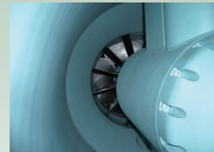
写真5 水車内部の可変翼
