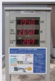
発電出力パネル
