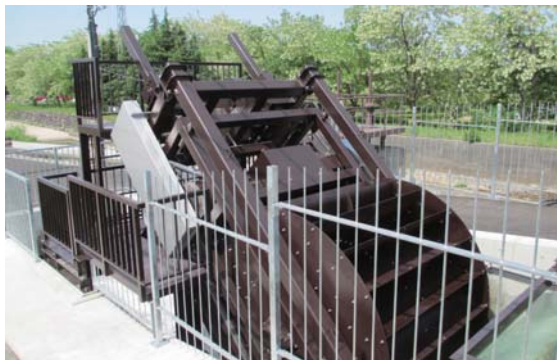
西番小水力発電所
