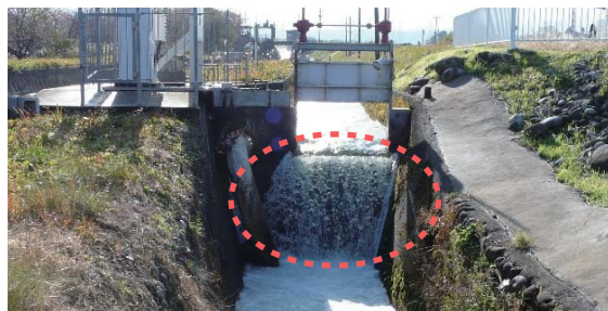
用水路の未利用落差
