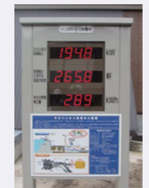
発電出力パネル
