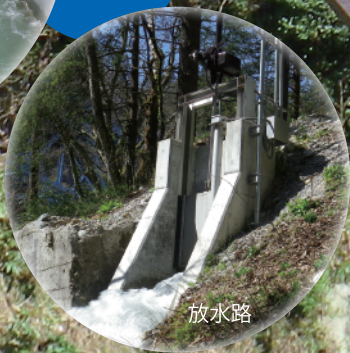
沈砂池・ヘッドタンク
