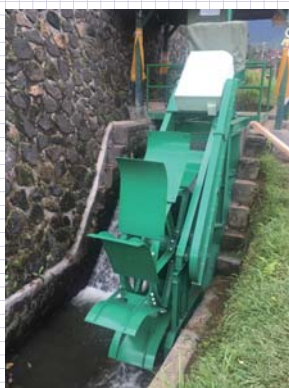
設置した水車 1
