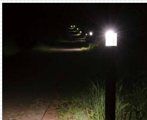
設置した外灯(夜間)
