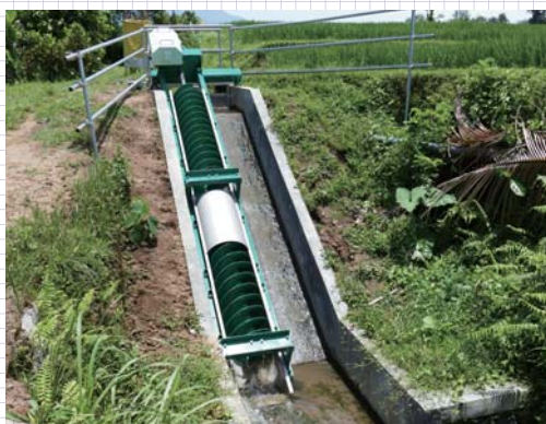
設置した水車 2
