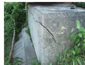
写真-4 鉄筋の不足による損傷例
