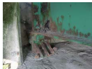
写真-1 鋼桁端部の腐食例
