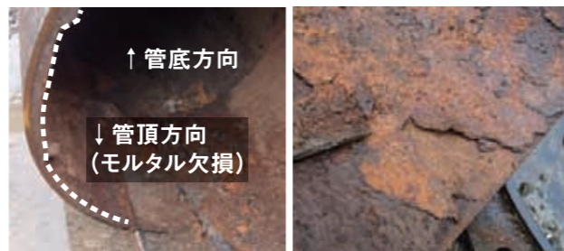
写真-2 破損管の状況
