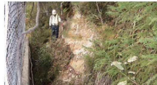
写真-2 施設背面斜面の崩壊
