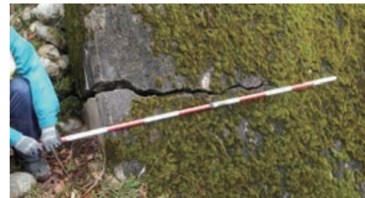
写真-1 擁壁工のひび割れ
