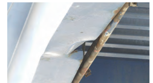
写真-4 主桁変形・欠損
