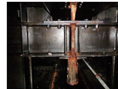
写真-2 ケーブルの腐食状況
