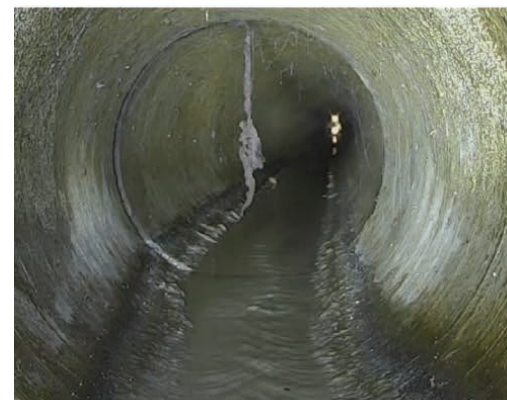
屈曲・蛇行・継手の異常
