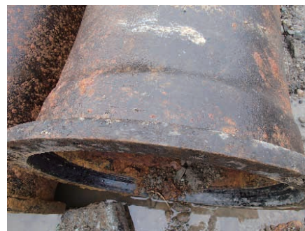
写真-1 撤去された管の状況 (接合部等にも鏽は確認できない)
