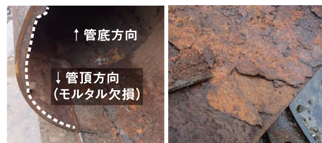
写真-2 破損管の状況
