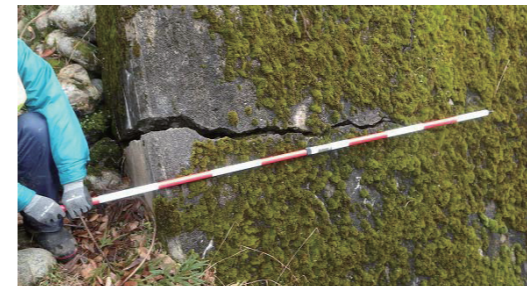
写真-1 擁壁工のひび割れ
