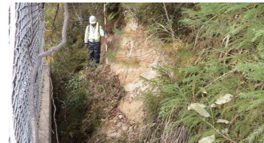
写真-2 施設背面斜面の崩壊
