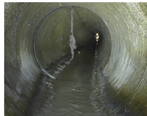
屈曲・蛇行・継手の異常
