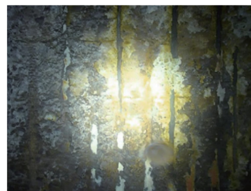
骨材・鉄筋露出（マンホール）
