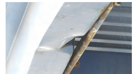
写真-4 主桁変形・欠損
