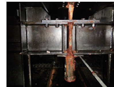
写真-2 ケーブルの腐食状況
